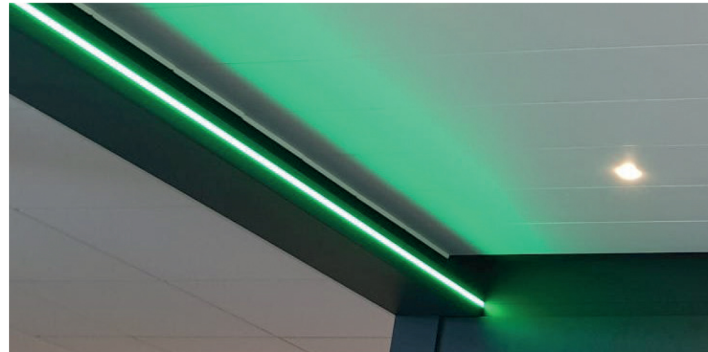
LED LIGHTING | LED-STREIFEN VERSTECKT IN DER REGENRINNE
